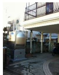
バナナ園ほりうち家に設置されたスプリンクラー用の貯水タンク<左銀色の物体>
